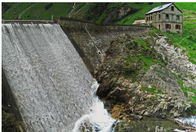
Barrage du lac d'Oô (Haute-Garonne) Déversoir en fonctionnement
