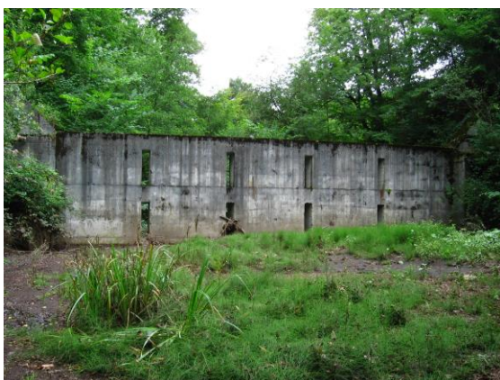
Barrage filtrant, pour retenir la charge solide du torrent en cas de crue (Haute-Garonne)
